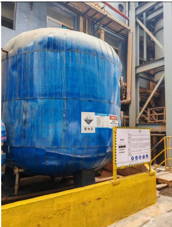
氢氧化钠储罐
